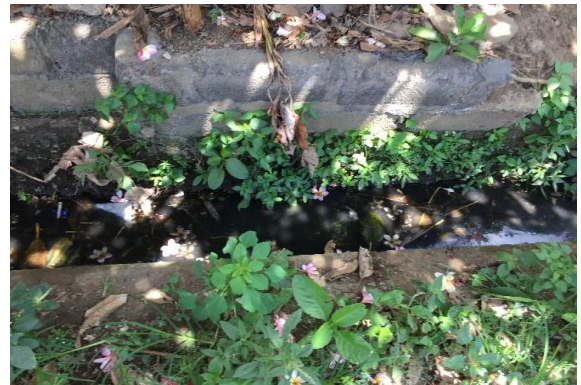
Gambar 7. Kondisi Saluran di Jl.Raya Belega
