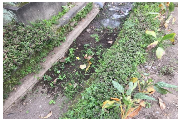
Gambar 4. Kondisi Saluran di Jl.Gunung Batur
