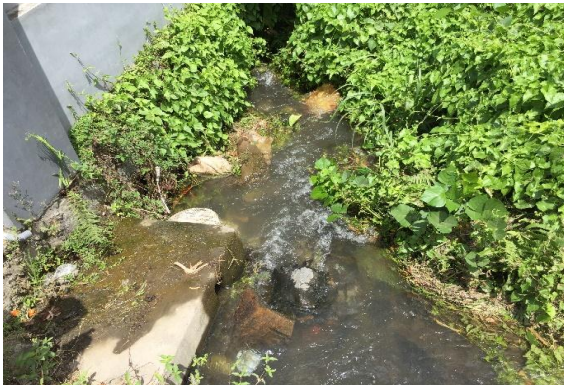
Gambar 5. Kondisi Saluran di Jl.Raya Tojan
